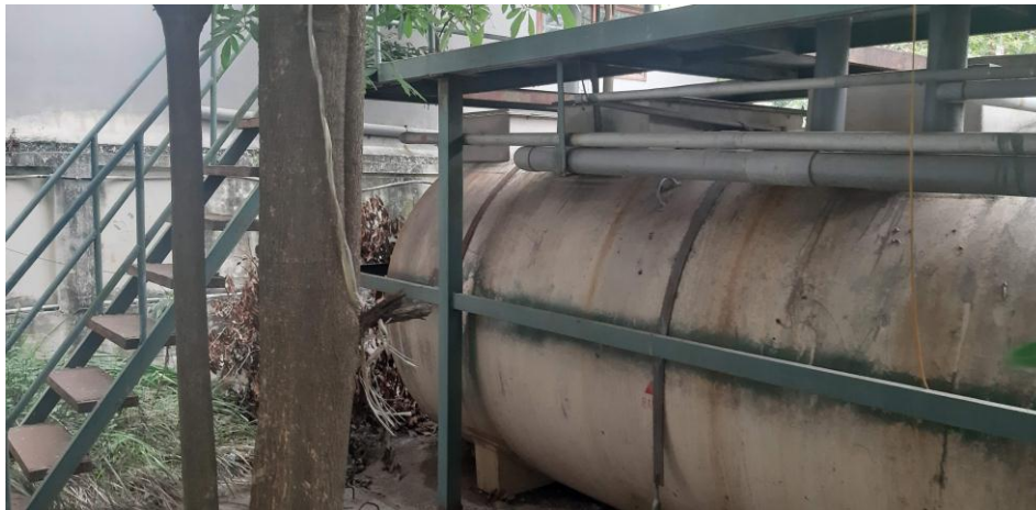
Hình 1.4.8: Hệ thống xử lý nước thải của Bệnh viện Mắt Hưng Yên Luận giải về việc đặt ra mục tiêu và những nội dung cần nghiên cứu của đề tài:
