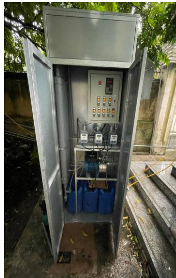
Hình 3.42: Ngăn đặt thiết bị điện (tủ điện, bơm, bơm định lượng hóa chất)
